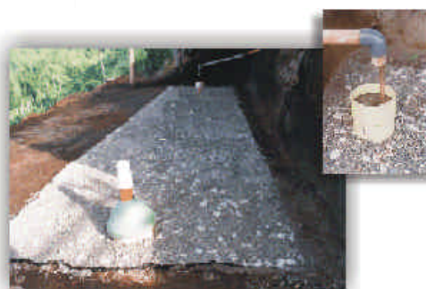
Figura 15. Entrada de lixiviados al FP.
