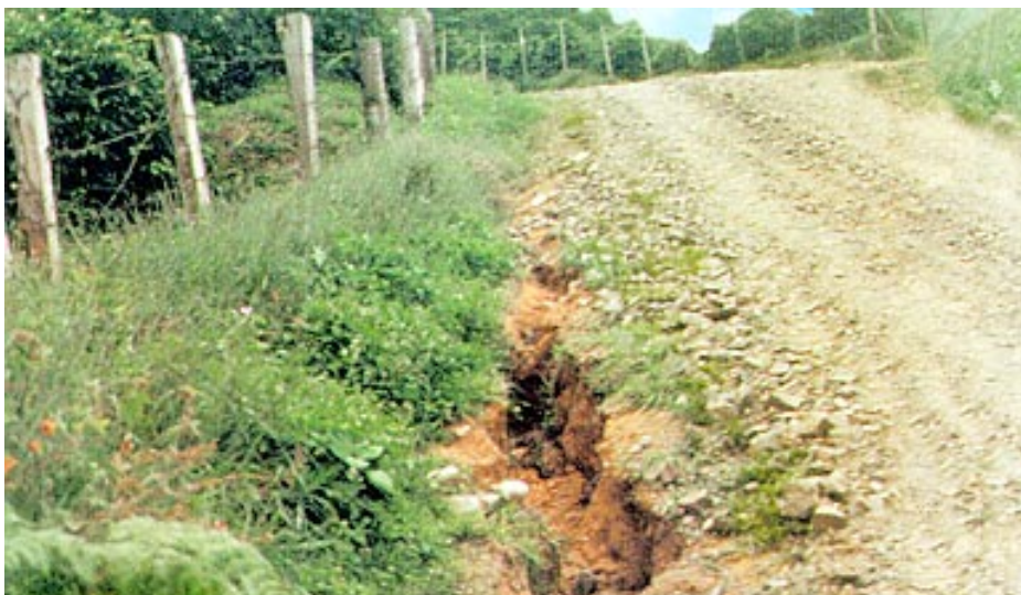
Figura 2. Cárcava profunda en cuneta de carretera por ausencia de coberturas vegetales.
