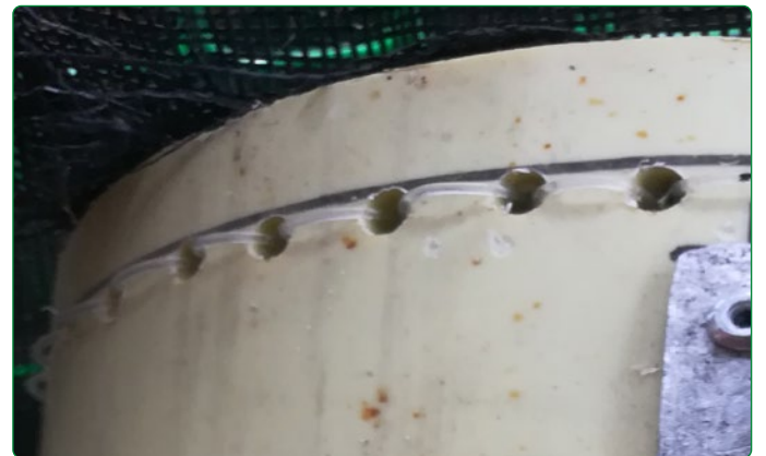
Figura 12. Detalle perforaciones al tubo PVC.
