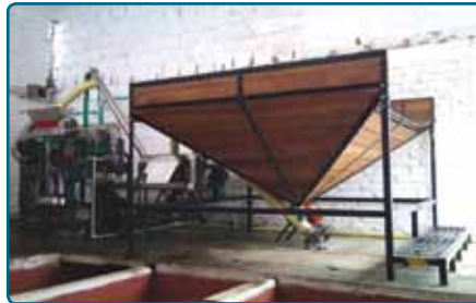
Figura 10. Instalación de un SHTTS con una tolva seca nueva.
