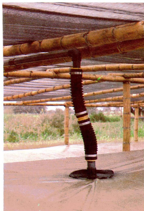
Salida del gas y protección.
