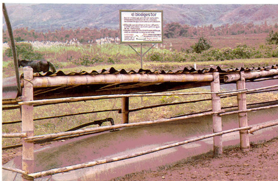
Biodigestor tipo “Cipav” en Jamundí - Valle.
