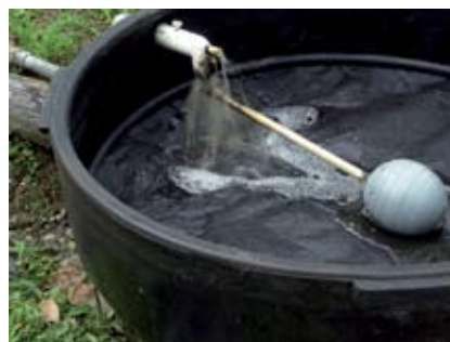
Figura 12. Llenado de la recámara de dosificación.
