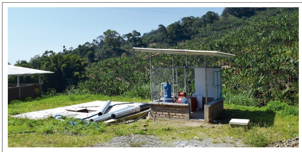
Figura 3. Tanque y sistema de bombeo de aguas llovidas.
