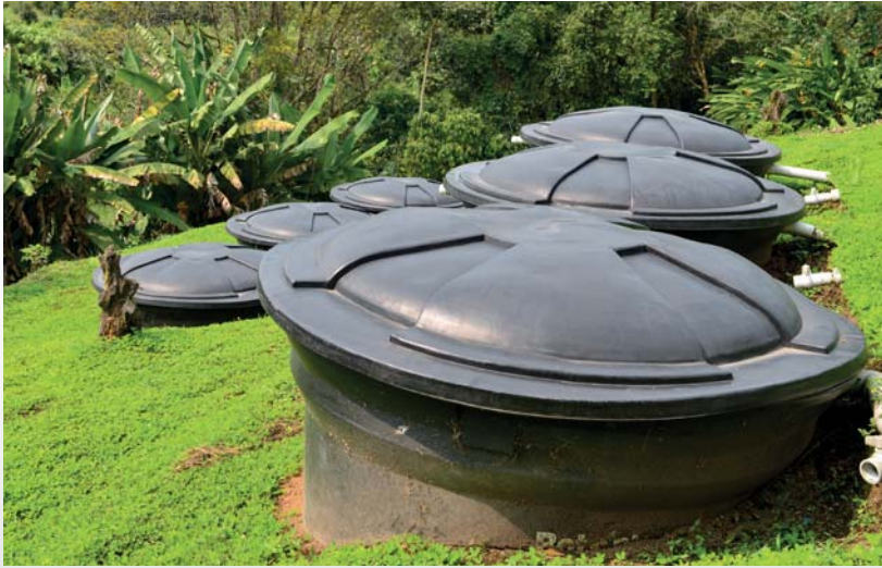
Figura 28. Filtros anaeróbicos semienterrados.
