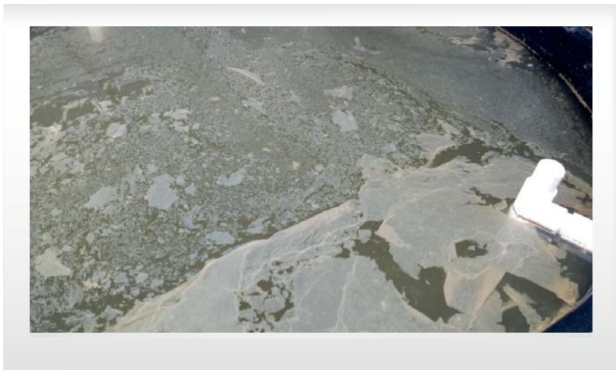
Figura 18. Aspecto de las grasas flotantes de la trampa de grasas.
