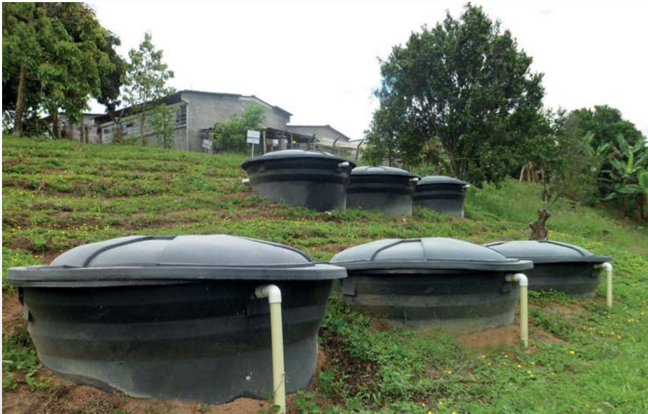
Figura 21. Tanques sépticos semienterrados.
