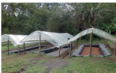
7 Aspecto final de los lechos de secado
