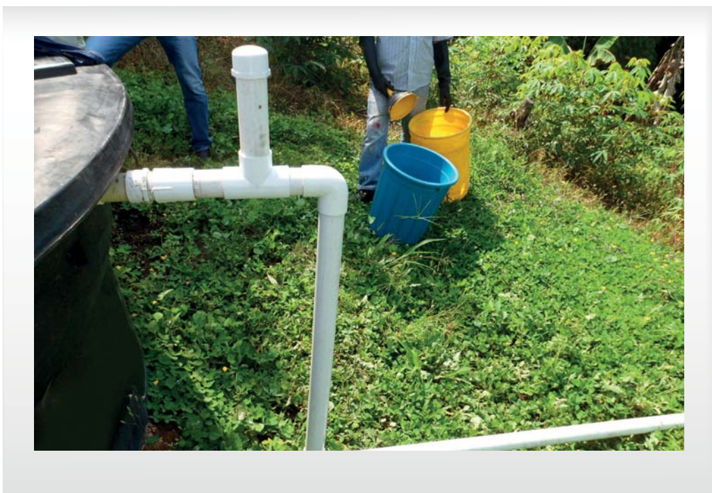
Figura 23. Dispositivo externo para la eliminación de lodos.
