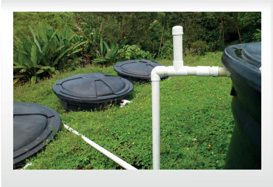
Figura 24. Acoplamiento del dispositivo de sifón invertido para la eliminación de lodos.
