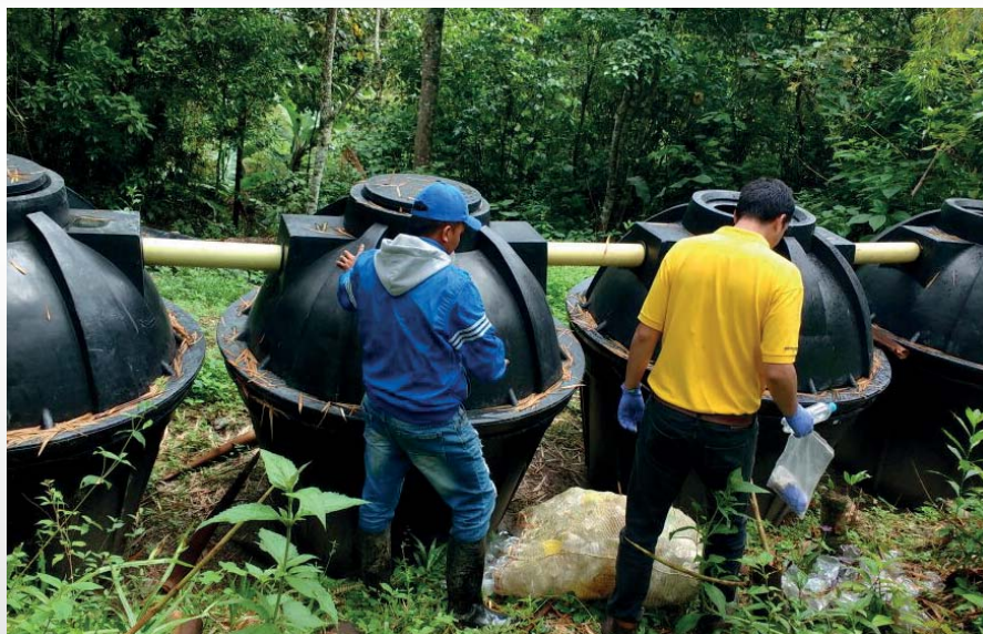
Figura 19. Tanques sépticos instalados en el departamento del Cauca.
