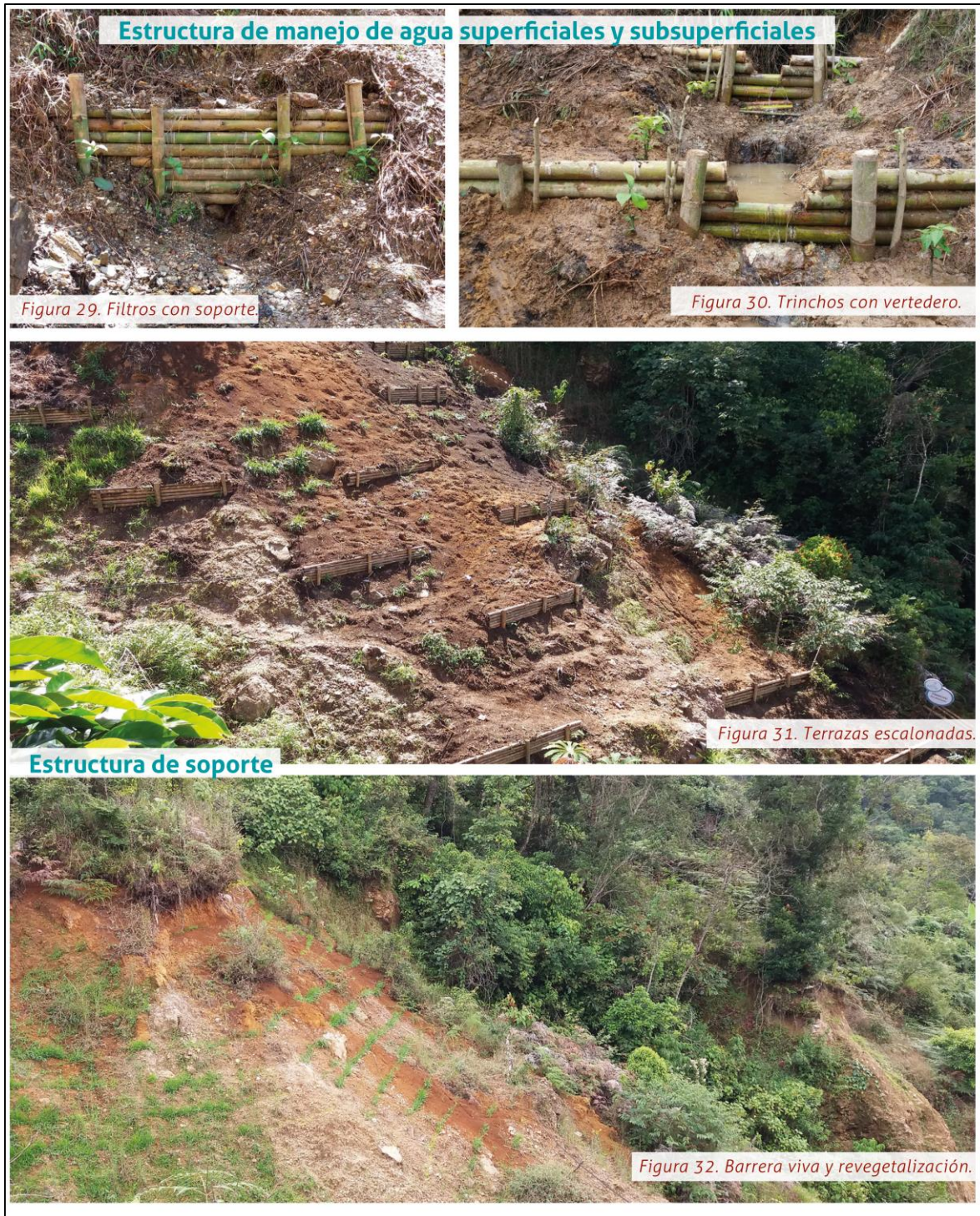
Aspecto de algunas de las obras de bioingeniería realizadas en el proyecto GIA.
