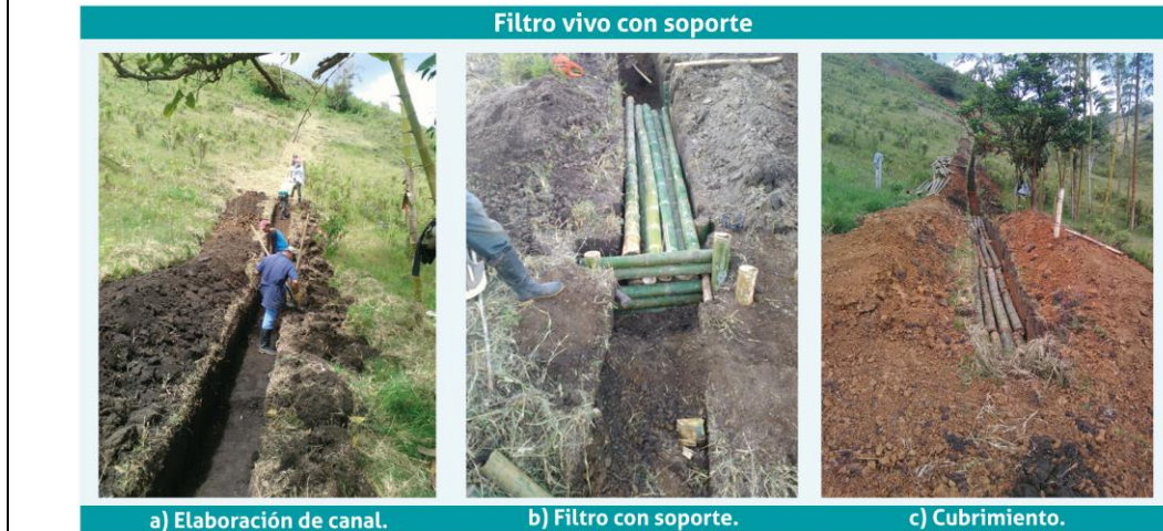
Aspecto de algunas de las obras de bioingeniería realizadas en el proyecto GIA.
