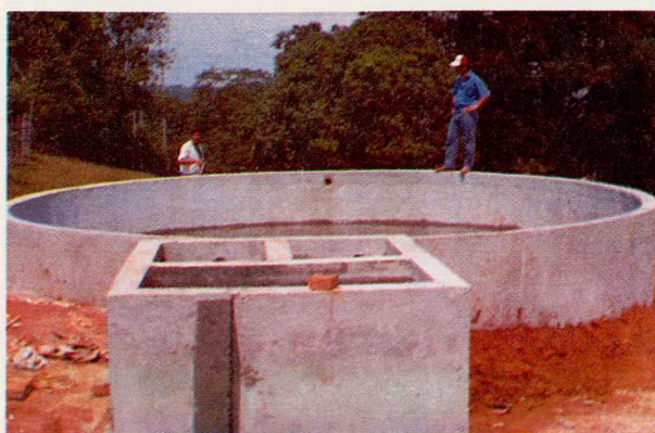
▲ Tanque de almacenamiento acueducto.. La Victoria.
