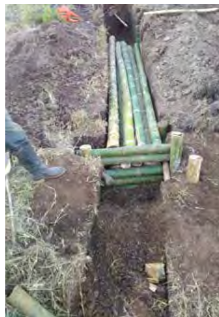
Figura 95. Filtros con soporte. Municipio de Bolívar, Valle del Cauca.
