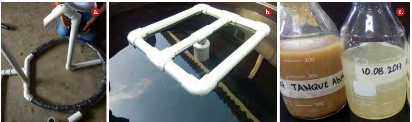
Figura 92. a. Dispositivo instalado en el interior del reactor hidrolítico-acidogénico de los SMTA. b. Dispositivo flotante de cabeza de presión constante del SMTA. c. Aspecto del agua de ingreso y de salida del dispositivo flotante.
