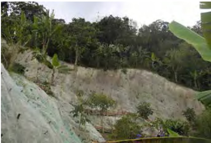
Figura 98. Cubrimiento del talud con biomanto y material vegetal. Municipio de Sandoná, Nariño.
