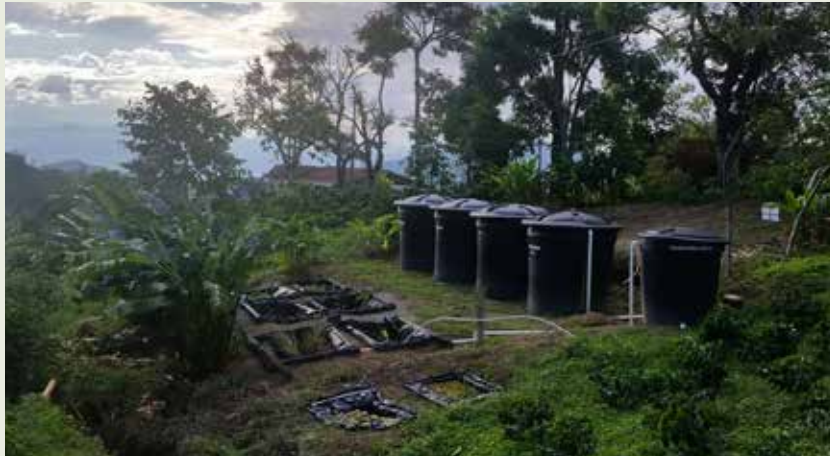
Figura 47. Sistema de tratamiento de las aguas residuales del café en la Estación Experimental El Rosario. Tratamiento secundario en un SMTA y tratamiento terciario en humedales artificiales.
