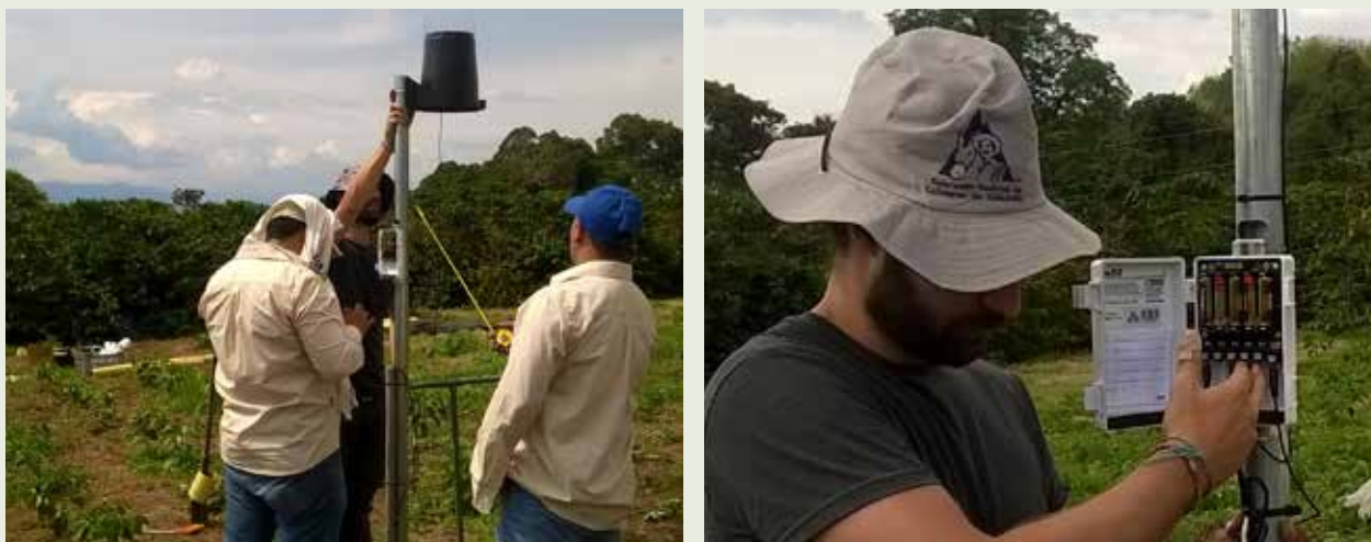
Figura 11. Instalación del pluviómetro a 2,5 m de altura y acople al datalogger.
