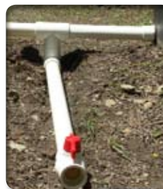
Figura 19. Entrada del agua miel al reactor hidrolítico y válvula de purga de gases.
