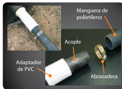
Figura 18. Acople entre los accesorios de PVC y la manguera de polietileno.
