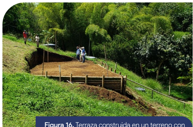
Figura 16. Terraza construida en un terreno con pendiente para la instalación del filtro verde.
