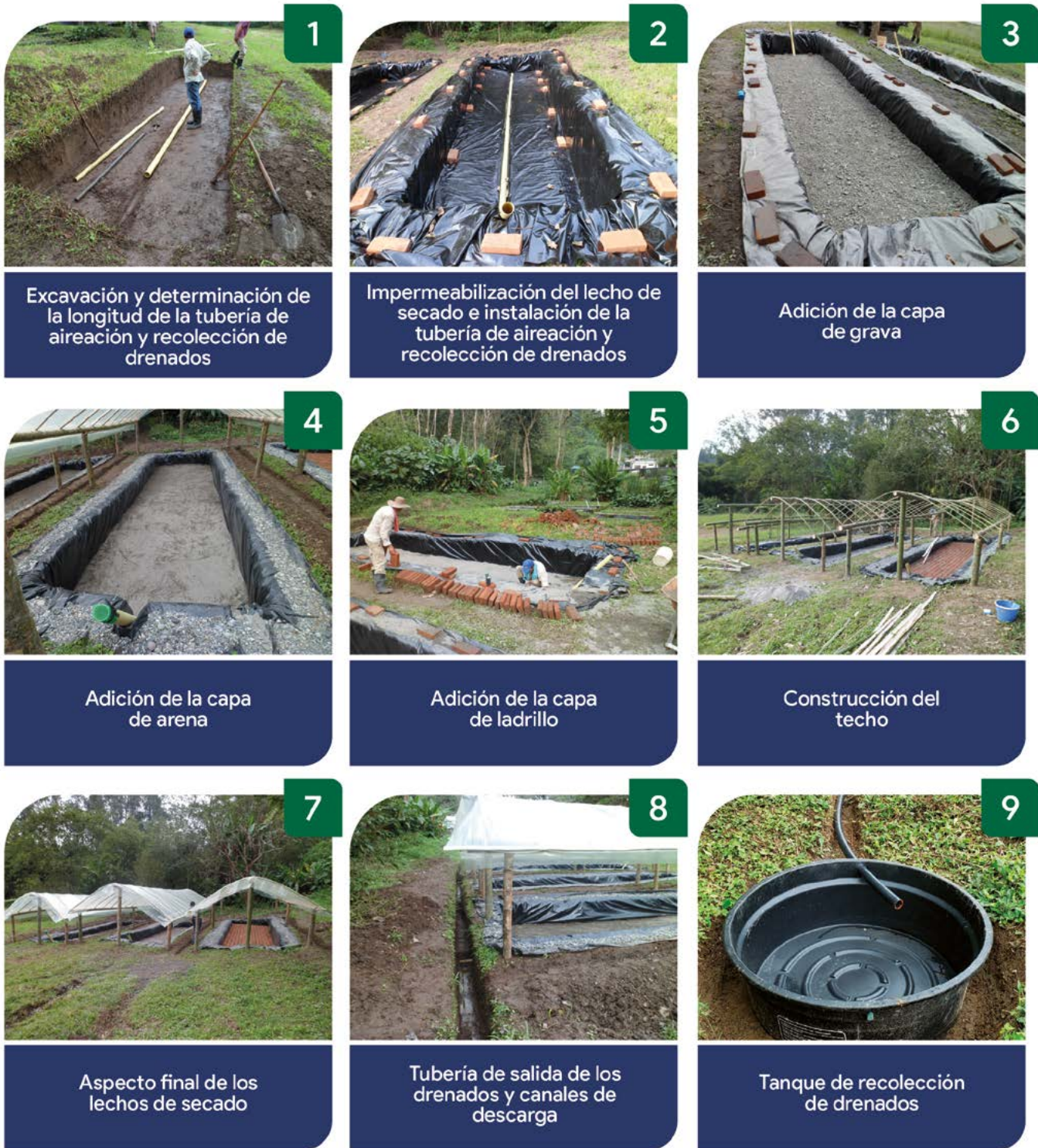
Figura 9. Construcción de un lecho de secado de lodos. Fuente: Rodríguez et al., 2022b.
