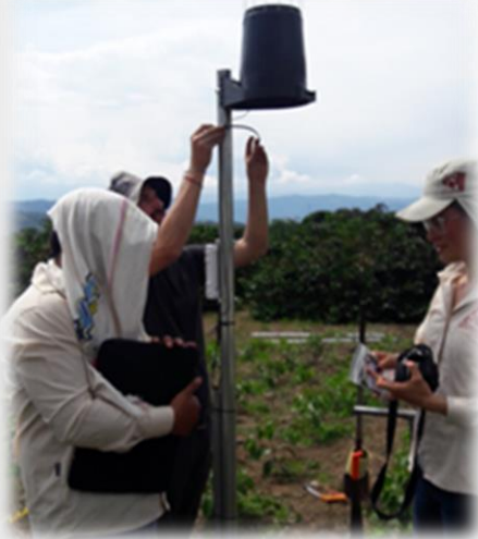
Pluviómetro de registro automático. Marca Davis
