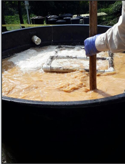
Agua residual proveniente del tanque tina, presente en el RHA.
