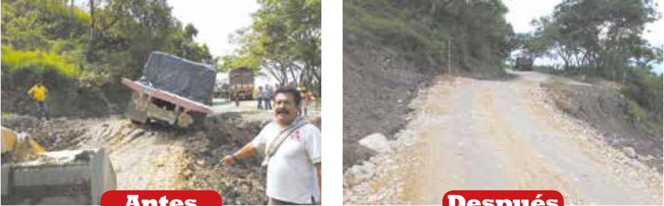
Foto Suministrada Kilómetro 24 Vía Prado - Dolores - Alpujarra (Los Mangos).
